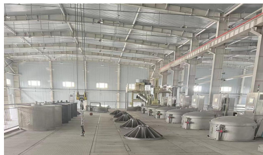
散棉/筒子纱无盐污水零排放染色生产线
